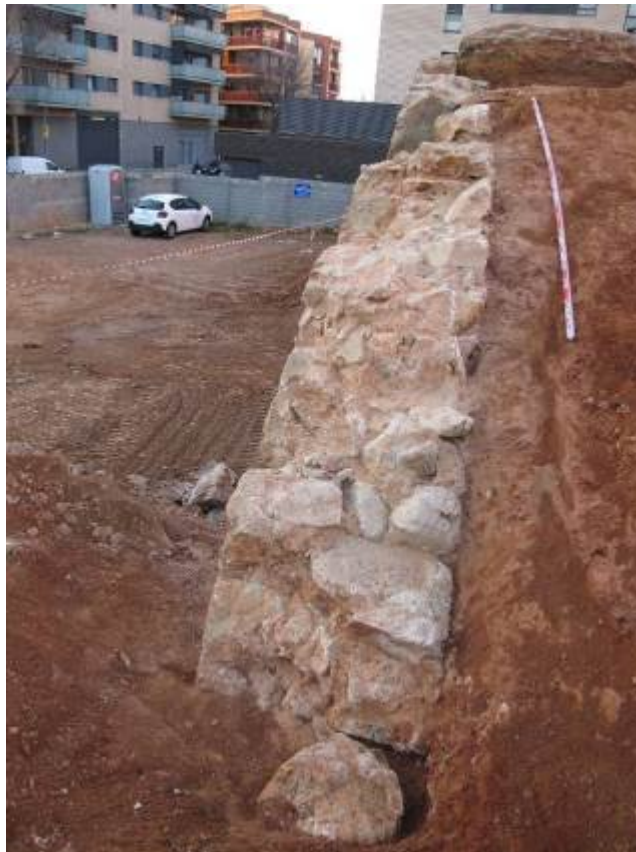
Foto 36: Mur UE 11, costat S, amb afectació per rampa
